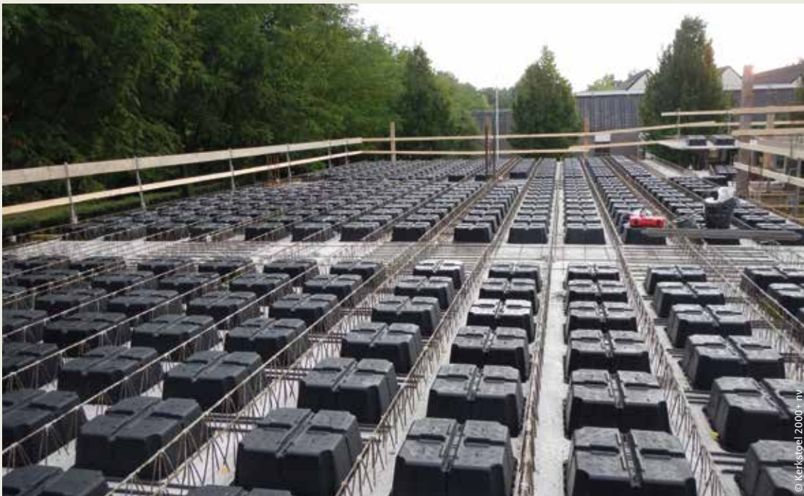
Fabrieksmatig aangebrachte holtevormers beperken het eigen gewicht van de vloer (zicht op de holtevormers voor het aanbrengen van de opstortlaag).
